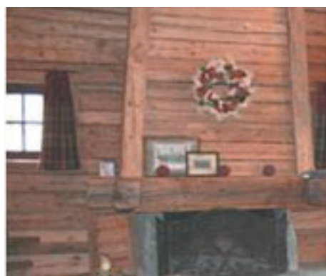
Cheminée dans chaque appartement
